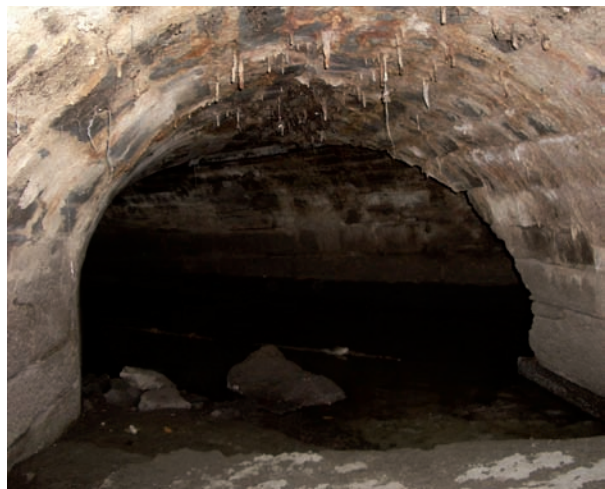
Abb. 41 Mit den Platzerweiterungen des 18. und 19. Jahrhunderts wurden die Mühlenkanäle überwölbt. Als unterirdische Bauwerke überdauerten sie teils bis heute. 2008 kam bei der Kanalisations-Sanierung das Nordende des Münzkanals zum Vorschein – hier der Blick vom Münzkanal in den Löwengrabenkanal.
