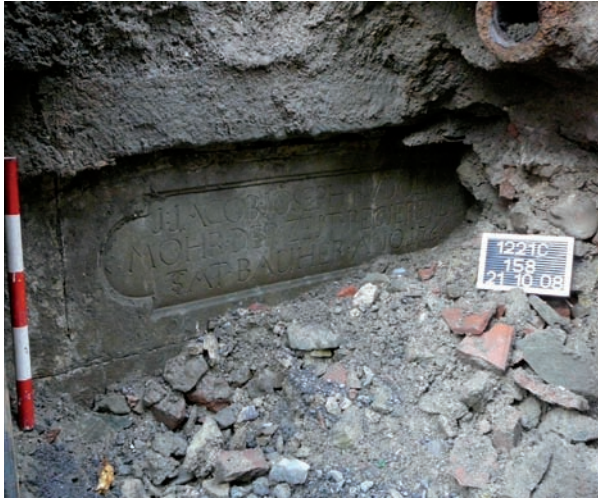
Abb. 37 Vom Neubau nach einem Hochwasser zeugt die sorgfältig ausgeführte Bauinschrift an der Aussenwange des Münzkanals: „J. Jacob Joseph Rudolph Mohr, der-zeit regierender Statbauerh Anno 1766“
