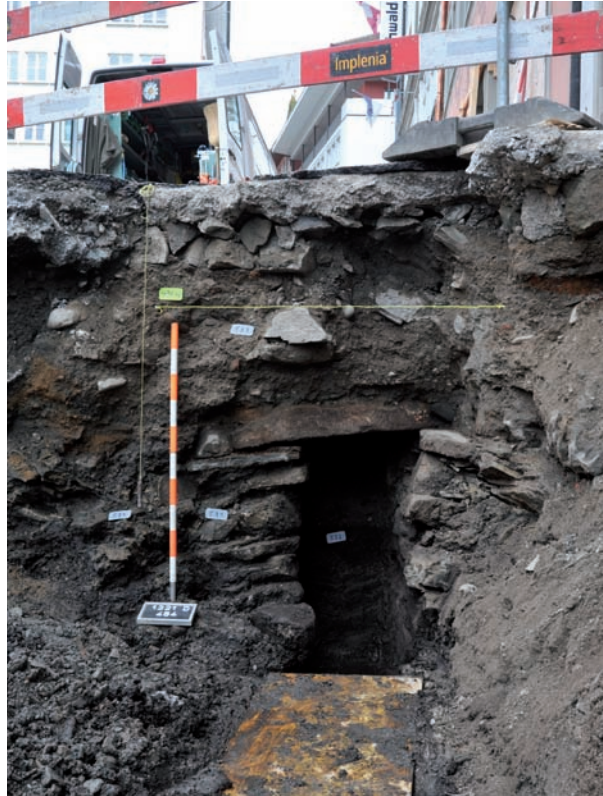
Abb. 16 Schnitt durch den mittelalterlichen Abwasserkanal, welcher unter einer Abdeckung aus Steinplatten in der südlichen, „vorderen Mühlengasse“ verlief. Dokumentation während der Bauarbeiten für die Kanalisation, Sommer 2009, Blick gegen Osten.
